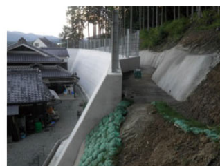
落石防止柵（川西市笹部）
