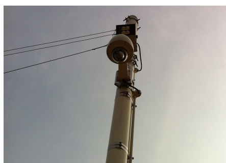
ため池の監視カメラの事例
